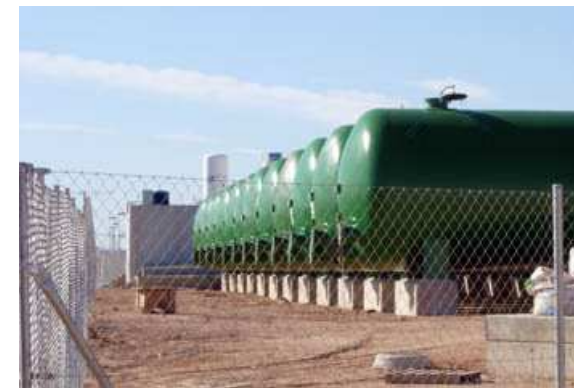
Tanques de desaladora de Murcia.
